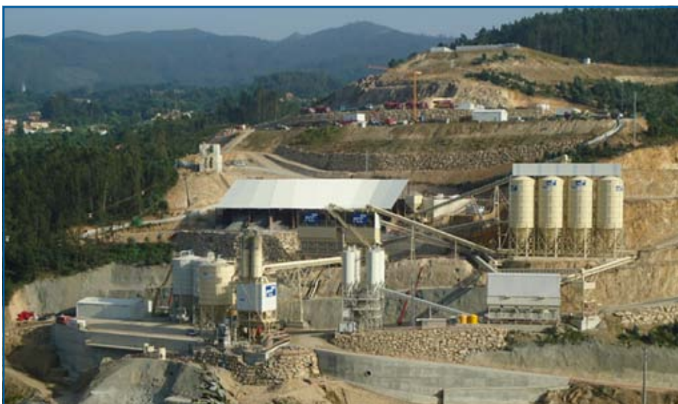
Instalaciones de producción de hormigón, presa de Ribeiradio y Ermida (Portugal)
