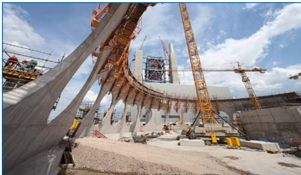
Central térmica de Karlsruhe (Alemania)
