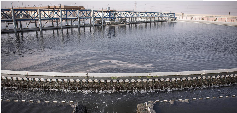
Depuradora New Cairo (Egipto).
