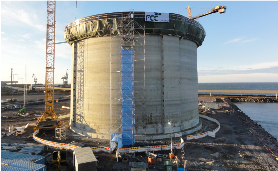
Tanque de GNL en Pori (Finlandia).
