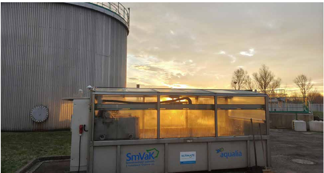
Secado de fango mediante sistema solar.
