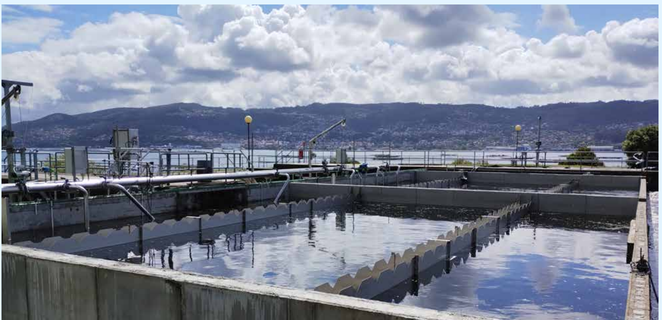
Reactores granulares del proyecto LIFE RESEAU en la EDAR de Moaña.
