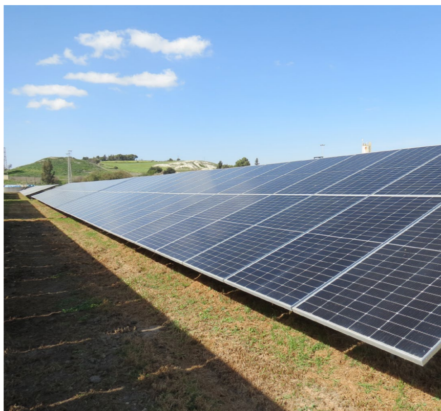
● Panneaux solaires installés dans la SEEU de Jerez de la Frontera, Espagne.
