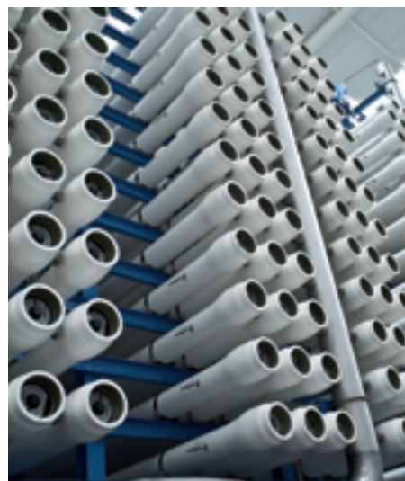
Bastidor de membranas de la planta Desaladora de CapDjinet.
