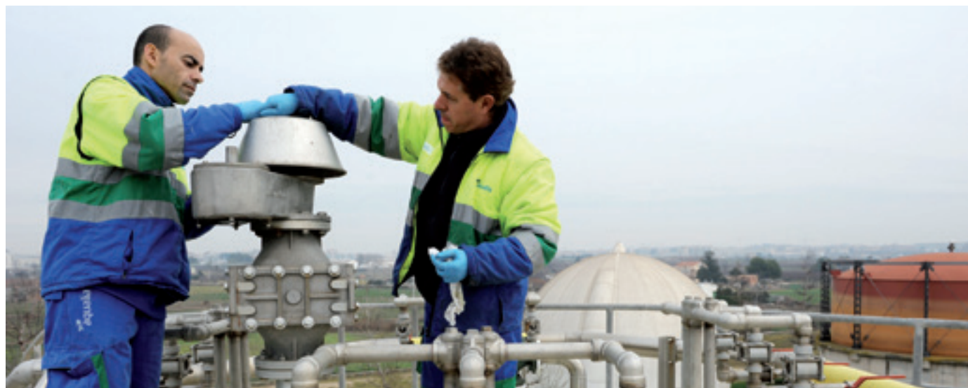
Operarios EDAR Lleida.
