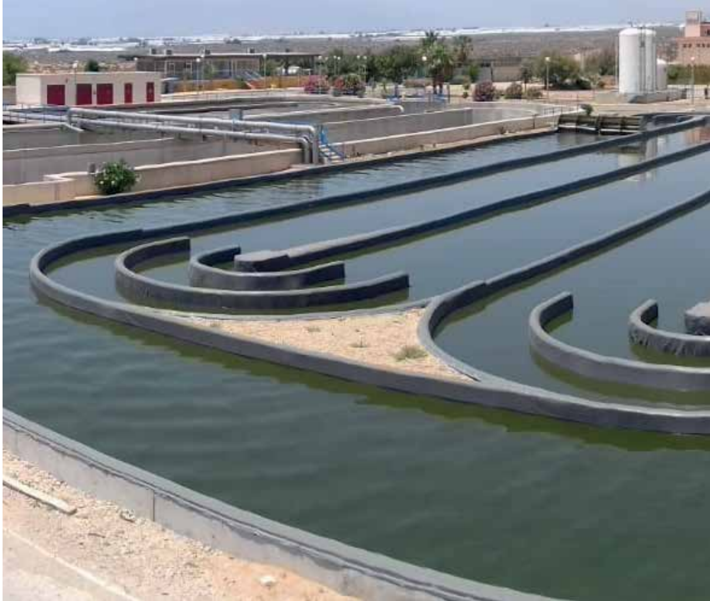
Proyecto Incover en la EDAR El Toyo (Almería).
