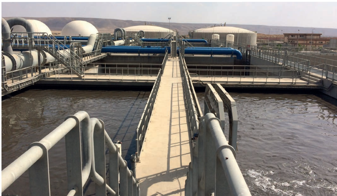
Estação de tratamento de New Cairo.
