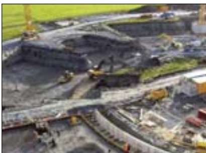
Sobre estas líneas, arriba, las obras del Vienna Oberlaa Spa; abajo, construcción del Tauern Spa World.
