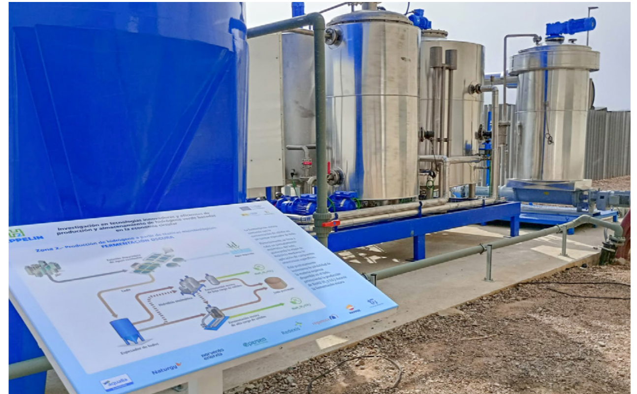
Estación Depuradora de Aguas Residuales (EDAR) Isla Verde de Algeciras (España).
