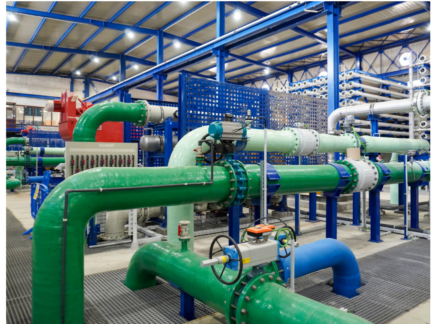
Estación Desalinizadora de Agua de Mar (EDAM) de Mar de Alborán (España).
