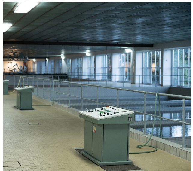
Planta potabilizadora de agua en Ostrava, República Checa.
