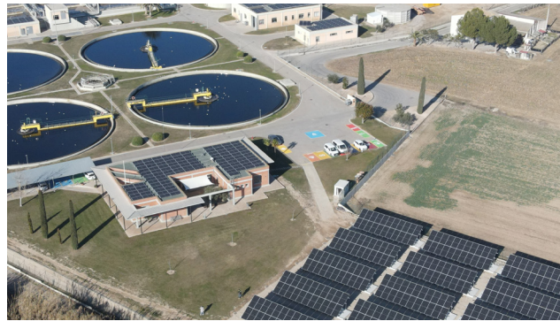
Placas solares instaladas en la EDAR de Lleida, España.
