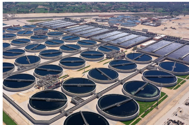
Planta Depuradora de Abu Rawash, Egipto.
