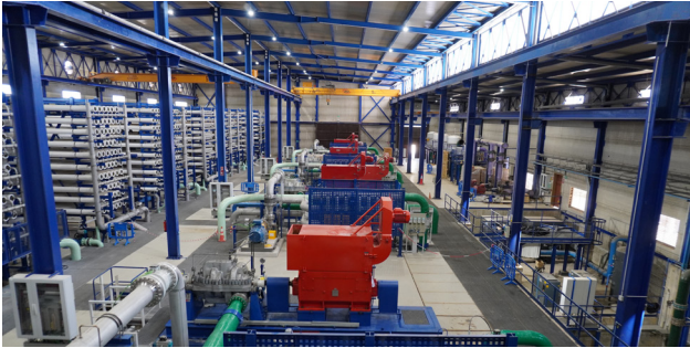
Interior de la desaladora Mar de Alborán, Almería, España.
