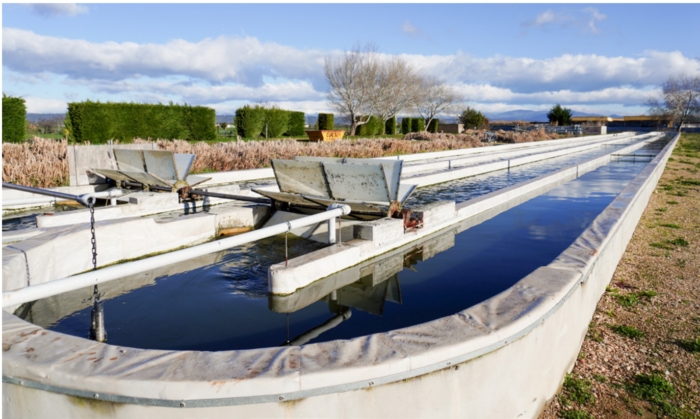
Estación Depuradora de Aguas Residuales (EDAR) de Talavera de la Reina (España).
