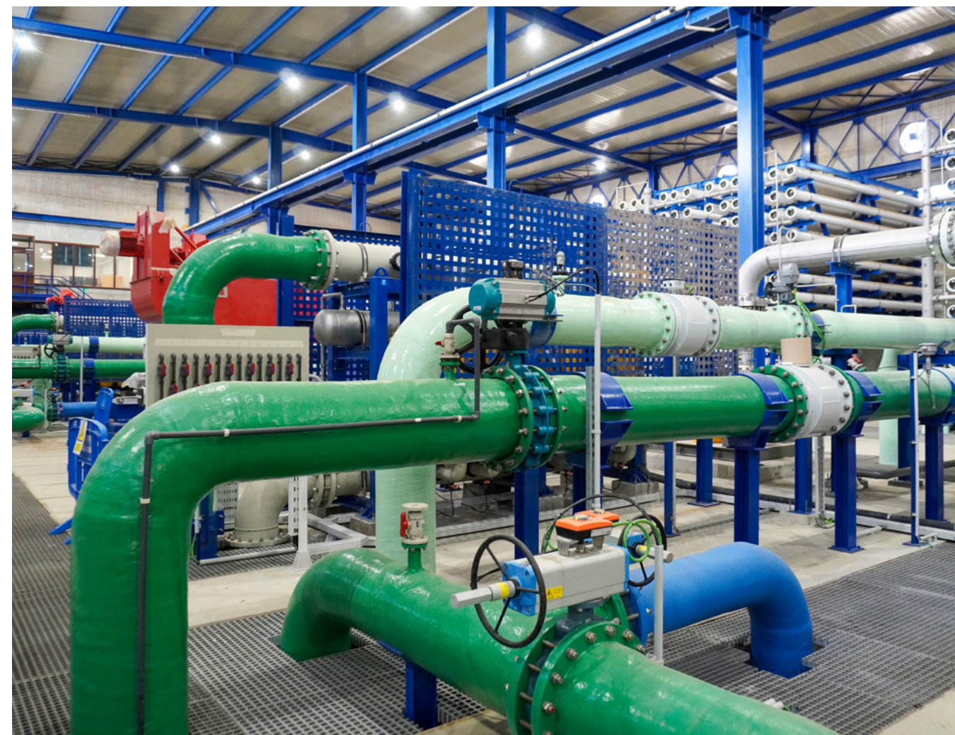
Estación Desalinizadora de Agua de Mar (EDAM) de Mar de Alborán (España).
