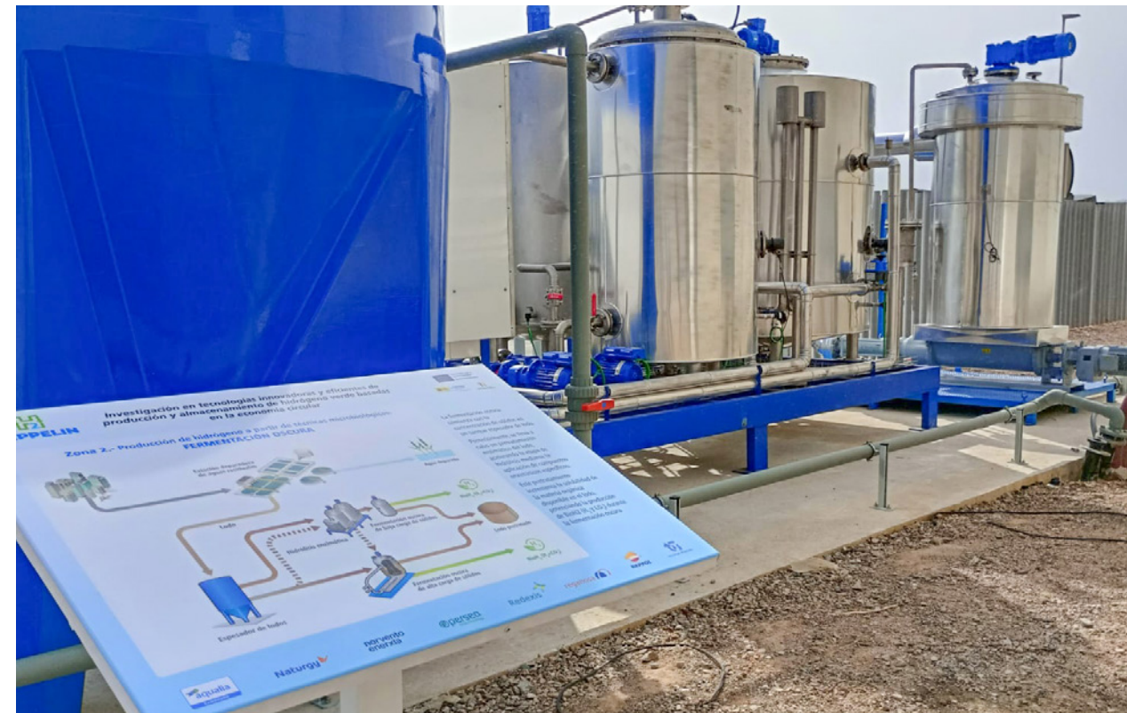
Estación Depuradora de Aguas Residuales (EDAR) Isla Verde de Algeciras (España).
